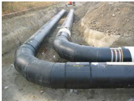
Figuur 1.7: Beeld van de warmteleiding bestaande uit de warme en "koude" retour.
